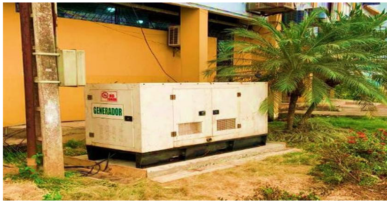
Figura 2: Generador de respaldo energético
