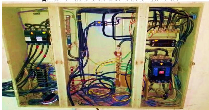
Figura 1: Tablero de distribución general.
